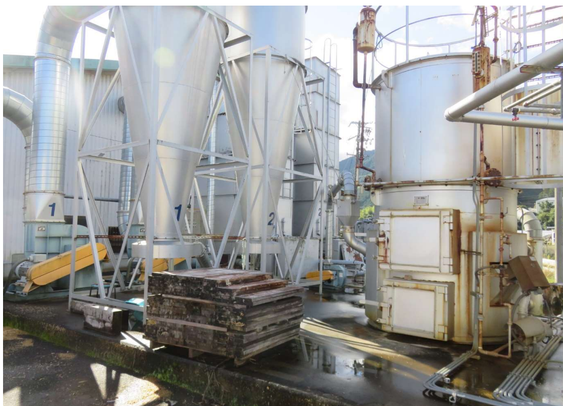
ボイラー・集塵設備
